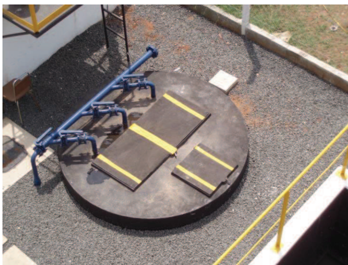
Figura 1. Estação Elevatória de Esgoto (EEE).
