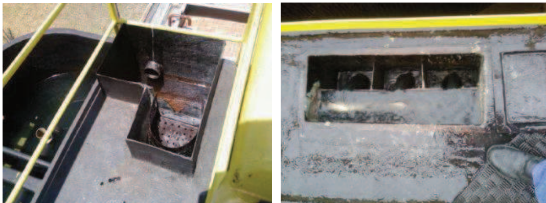
Figura 3. Caixa de areia e de distribuição do esgoto no reator UASB.
